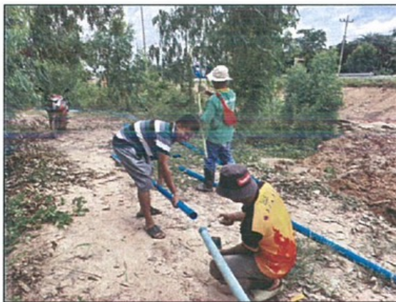
แจ้งเหตุประปาขัดข้อง เลขที่รับแจ้ง ๐๐๐๐๖/๒๕๖๗ วันที่ ๖ กันยายน ๒๕๖๗
